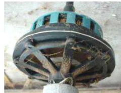
写真1 汚れた調圧器
