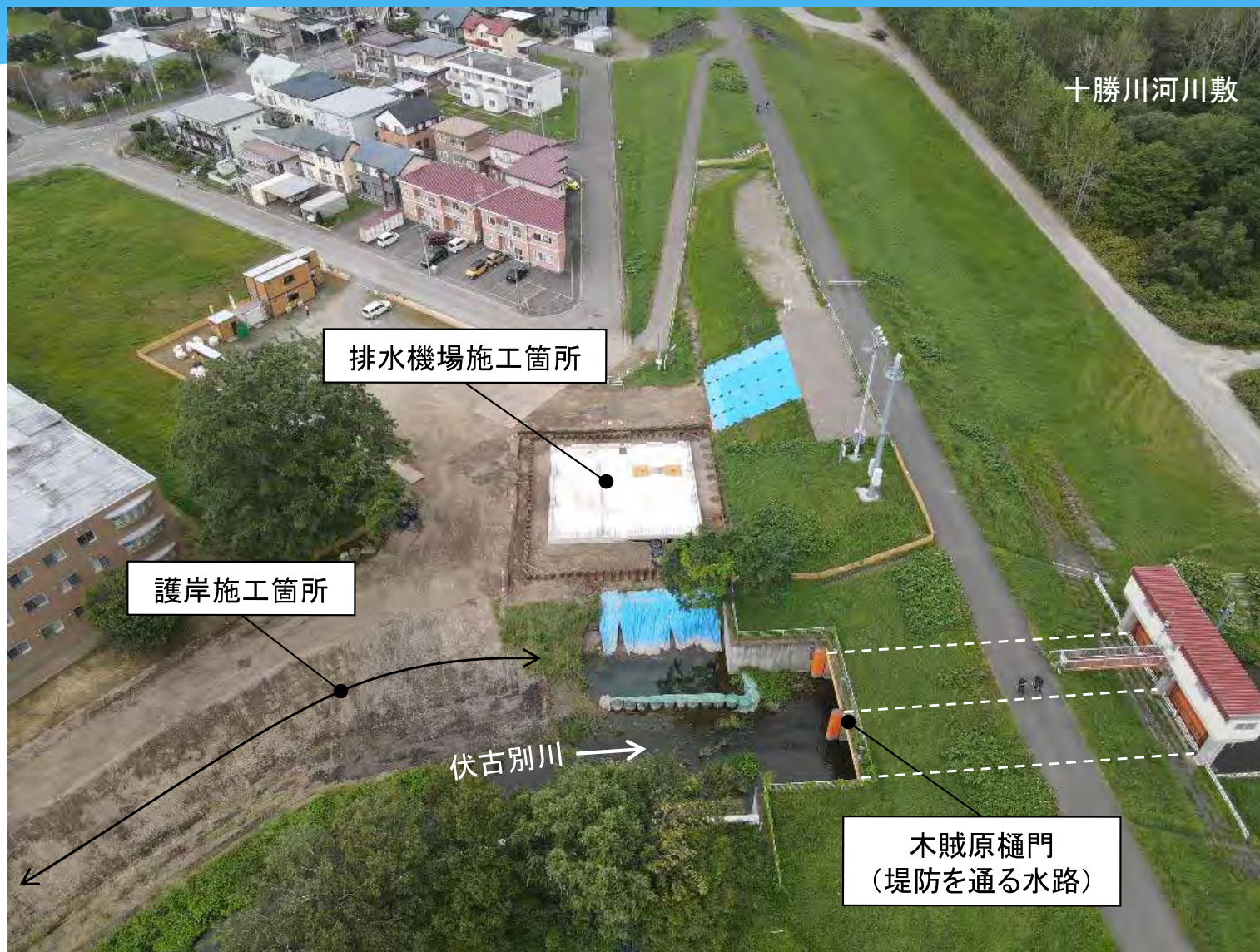
木賊原樋門上流 改修工事・排水機場の施工箇所状況 (R4.9.5)
