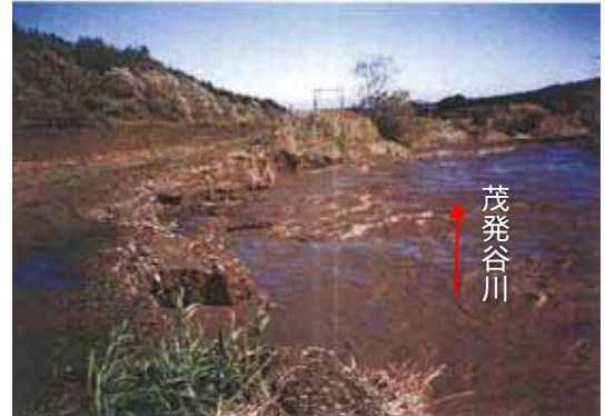
▲ ホーブランド橋下流左岸の氾濫跡 < 平成14年10月 >
