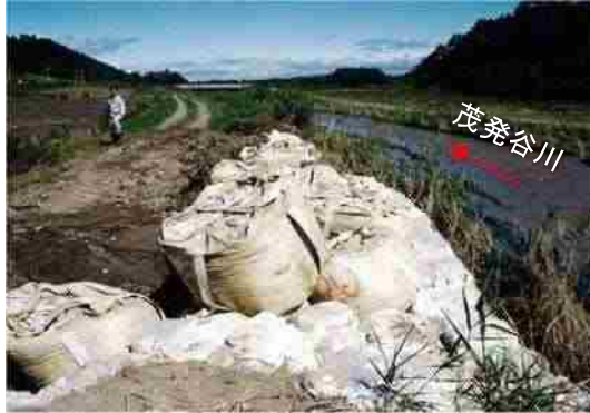
▲茂発谷川第2号橋上流の河岸欠壊 ＜平成10年9月16日＞
