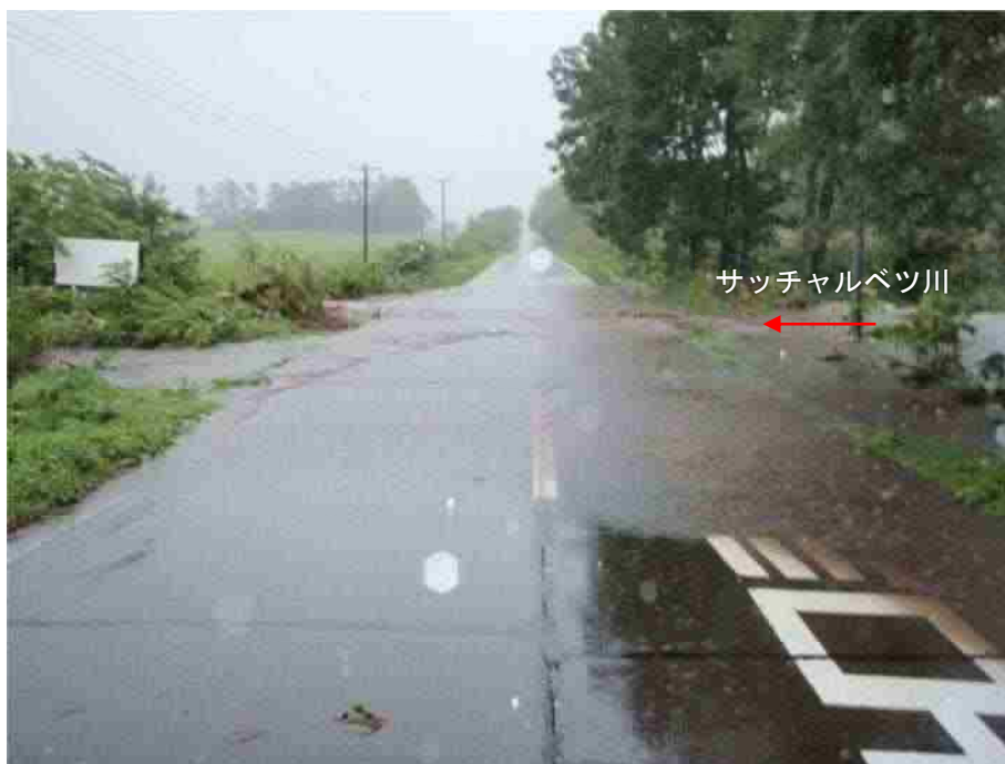
▲村道東 5 号線の道路冠水状況 ＜平成 23 年 9 月＞
